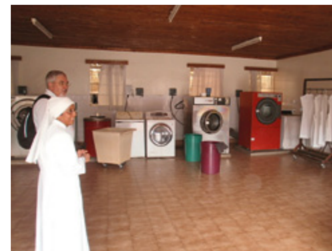
La lavanderia del centro anziani: gli operatori sono 24
